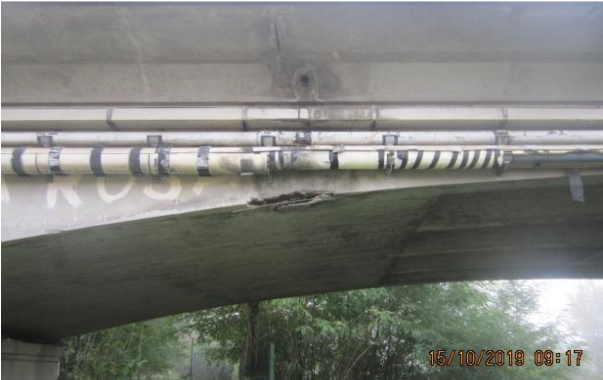
DANNEGGIAMENTO DA PERCOLAMENTI DAI PLUVIALI SENZA PROLUNGA.
