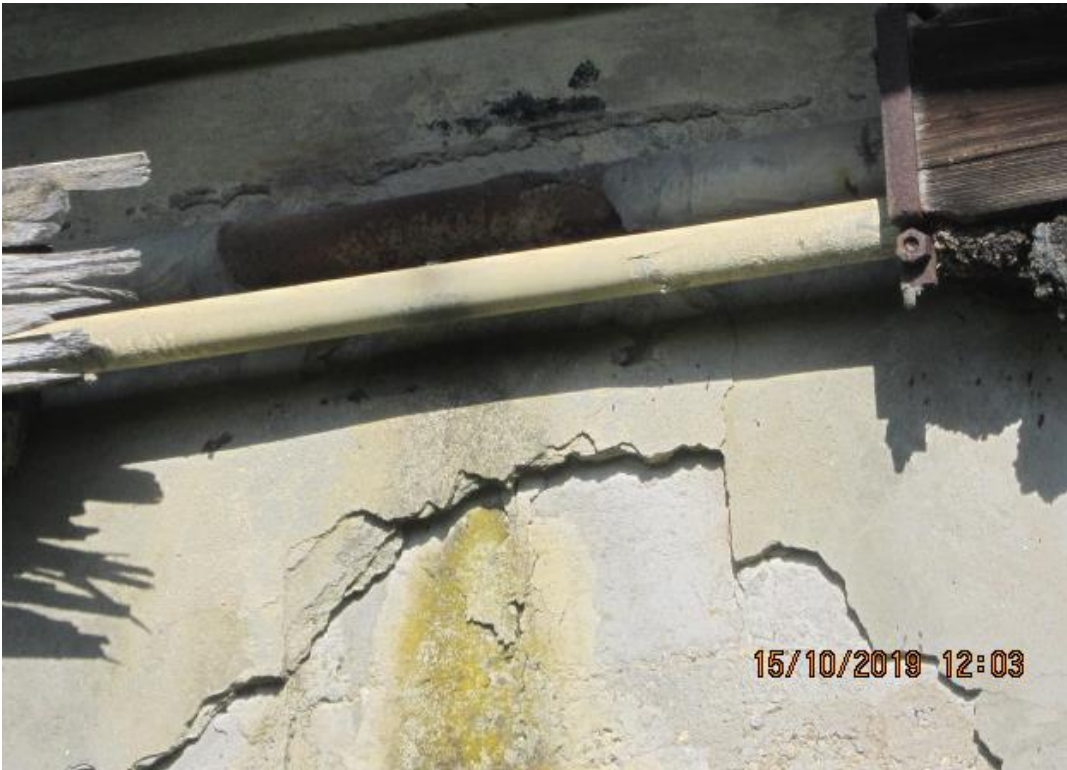
DISTACCHI RIVESTIMENTO PROT. Eseguito diversi anni addietro
