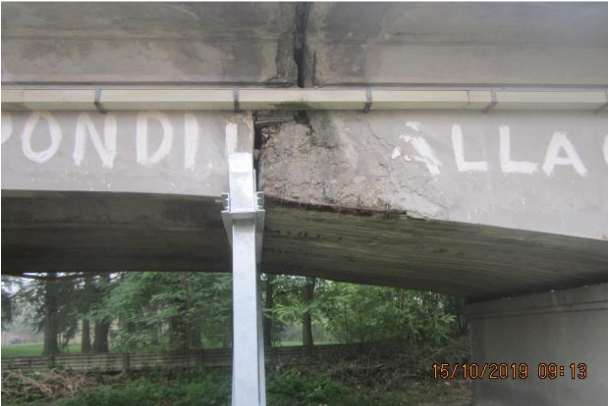
Telaio di sicurazza montato in occasione del TRANSITO ECCEZIONALE 2019-VISTA LATERALE
